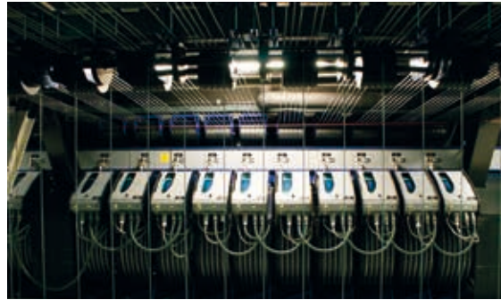
Abb. 73: Seilwinden-Steuerung für ein Musical im Londoner Palladium Theatre – Quelle: Courtesy of Trekwerk
