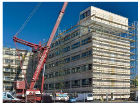
Abbildung 31: Vorgefertigtes Baumodul unter Einhaltung der Installationszonen Quelle Wieland Electric GmbH
