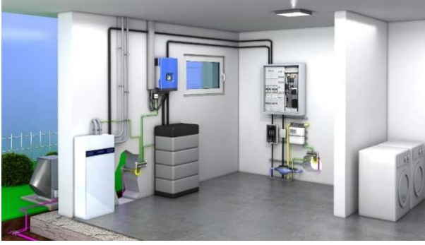
Abbildung 36: Technikraum eines Wohngebäudes mit niederimpedanter Anbindung von Betriebsmitteln in den Potentialausgleich, Quelle Dehn SE
