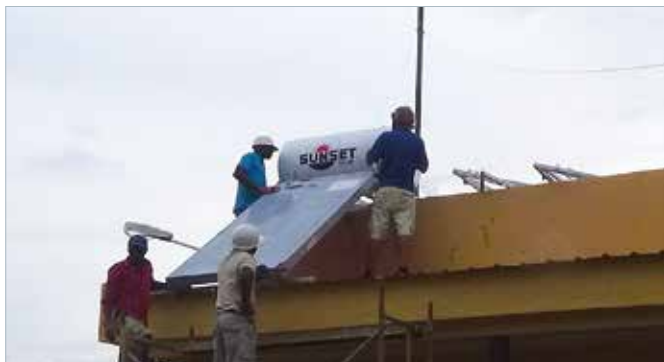
Photovoltaik, Solarthermie und Windenergie: Nutzung verschiedener Anwendungen Erneuerbarer-Energien-Technologien an der Missionsstation Sambo bei Huambo. – Photovoltaics, solar thermal energy and wind energy: Use of various applications of renewable energy technologies at the Sambo missionary station near Huambo.
