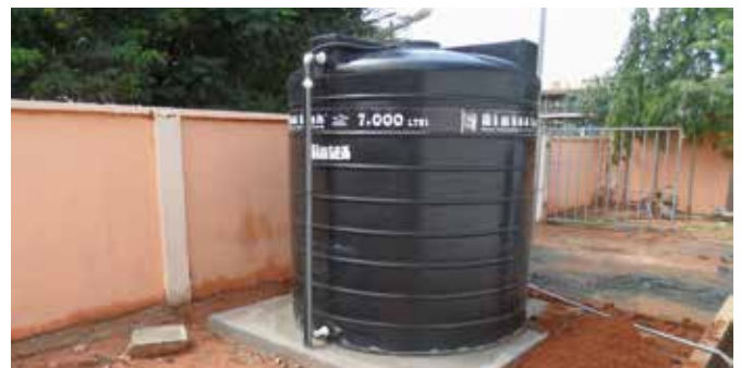
Solarpumpe mit Wassertank zur Warmwasserversorgung – Solar Pump and water tank for hot water supply
